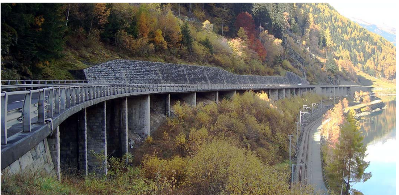
Sechs Brücken mit einer Gesamtlänge von 600 Metern müssen in den Jahren 2014 – 2017 instand gestellt werden.
